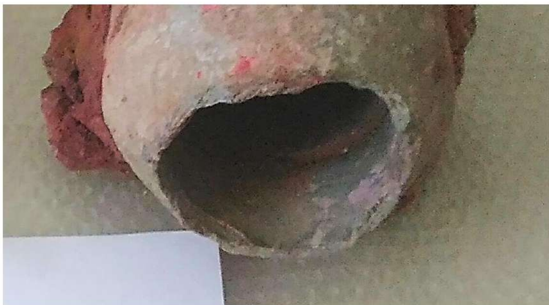
Figura 6 – rotture nette del colletto in MCA rinvenuto in P1, dopo incapsulamento e confezionamento
